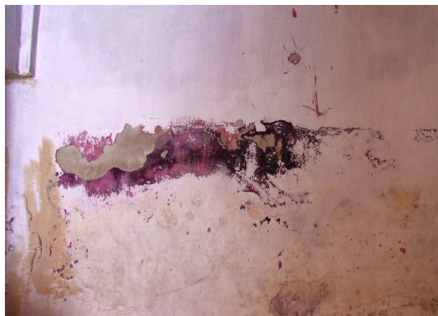
Figura 2. Marca de agua en la pared casa de Carol, Jardim Romano, São Paulo. Fuente: Rio desborde (Vivian Castro, 2019)
